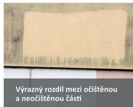
Šetrný způsob čištění a ošetření zarostlé fasády
