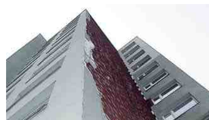
Důsledek neřešení ztráty stability zateplovacího systému
