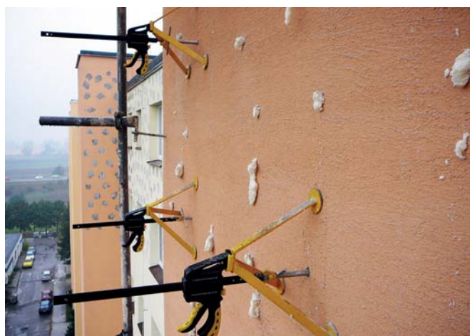
Dokotvení nestabilního zateplení - sanace nestabilních zateplení za pomoci moderního způsobu injektovaného kotvení.
