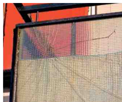
Popraskané výplně balkonového zábradlí jsou jedním ze znaků stárnutí panelových domů.
