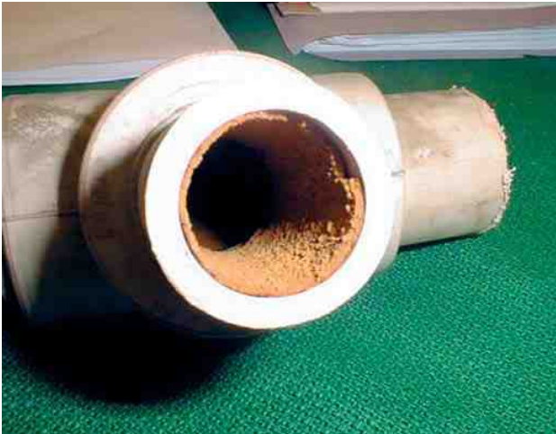
Potrubí PWH-C (je z PPR) po třech letech provozu
