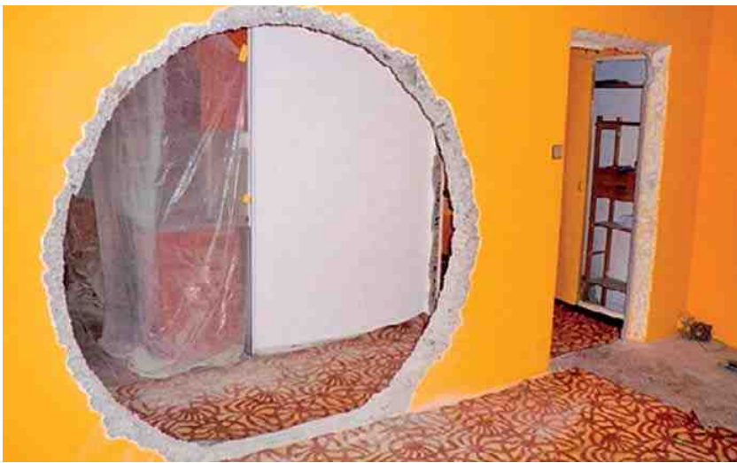
Jeden z odstraňujících případů, který odborníci ČKAIT uvádějí: Majitelka si nechala ve stěně vytvořit velký kruhový průchod. Neověřila si, že jde o nosnou zeď, a nad ní se nacházely další čtyři byty.
