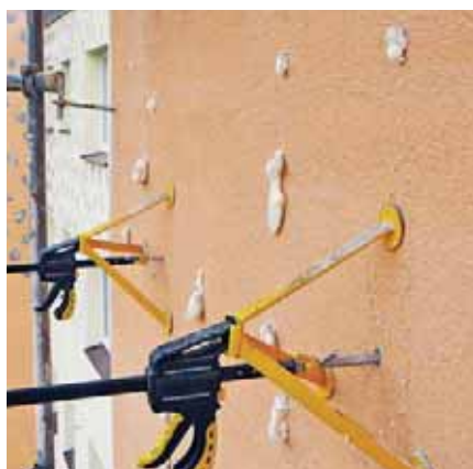
Obr.: sanace nestabilního ETICS
