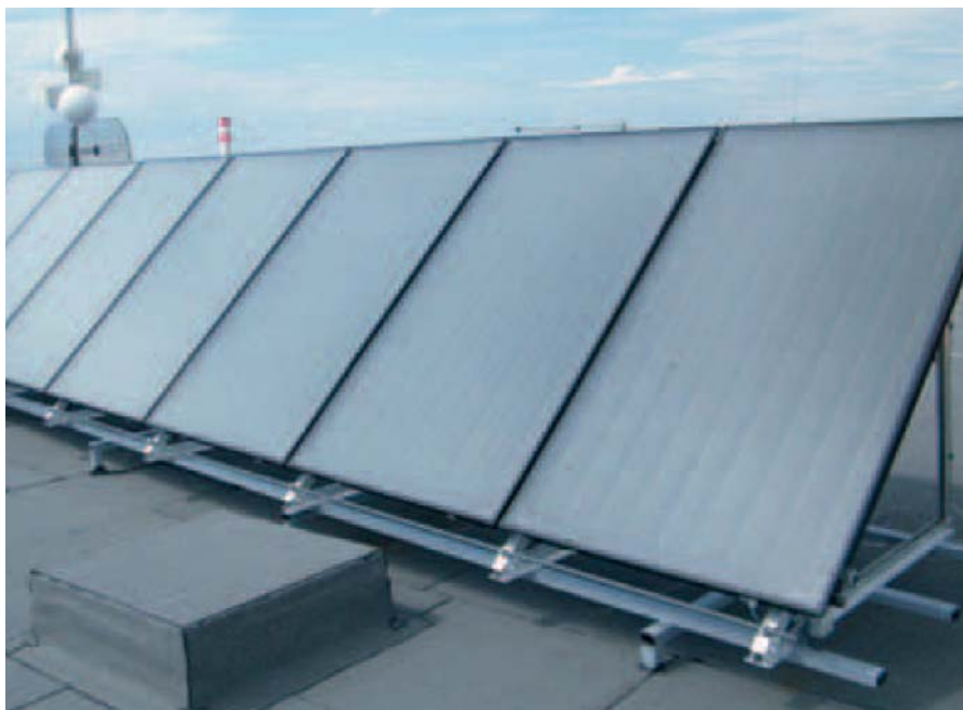
Solární kolektory Logasol SKN 3.0 na ploché střeše domu
