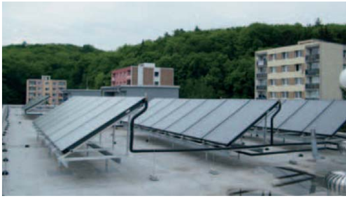
Solární kolektory na bytovém domě
